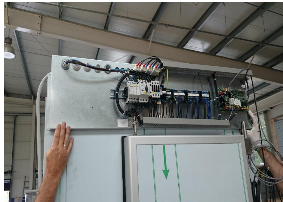
Fot 22. Panel zasilania nad drzwiami ze zdjętą osłoną.
