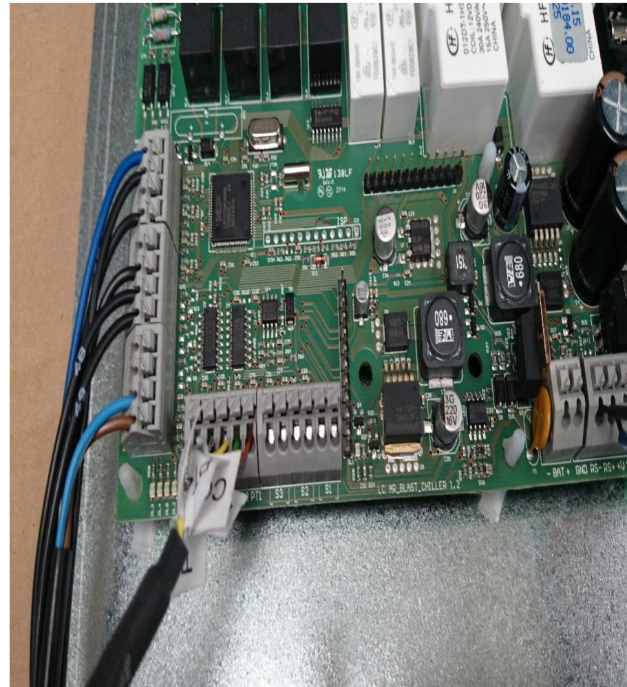
Fot 34. Miejsce podłączenia czujek temperatury S1 i S2 na płycie sterującej.
