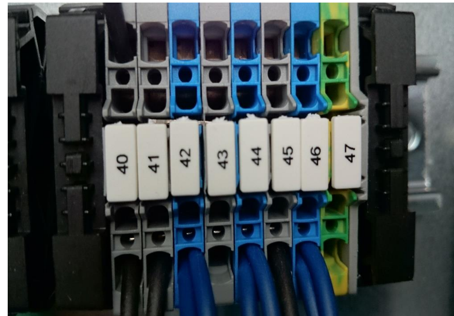
Fot 30. Miejsce podłączenia zabezpieczeń agregatu (zgodnie z oznaczeniem przewodów 40-47).
