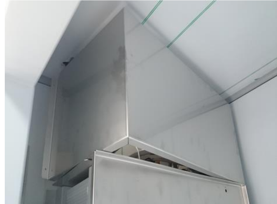
Fot 26. Osłona nad parownikiem (po zamontowaniu zaworu rozprężnego
